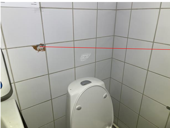
#5 Ingen fugtsikring bag vægfliser.
