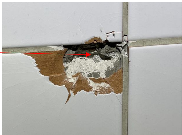
#6 Ingen fugtsikring bag vægfliser.
