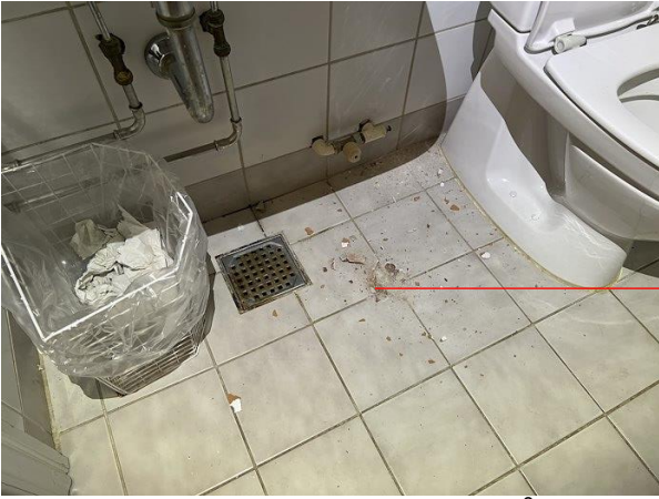
#7 Ingen fugtsikring under gulvfliser på toilet.
