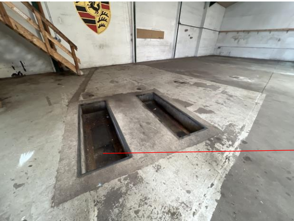
#9 Misfarvet betongulv i grav.
