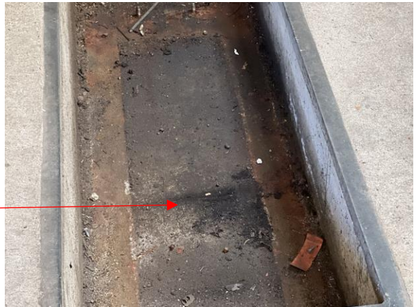
#10 Misfarvet betongulv i grav.
