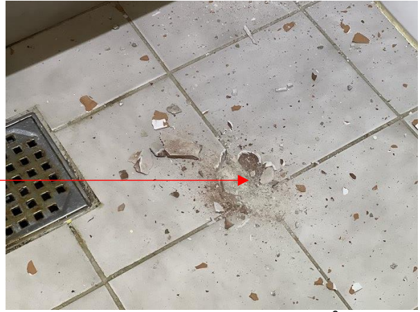
#8 Ingen fugtsikring under gulvfliser på toilet.
